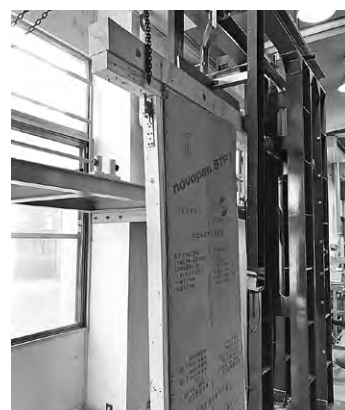
ノボパン破損状況
