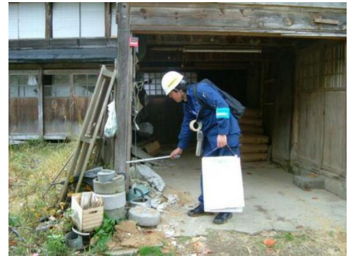
被災した建物の判定活動
